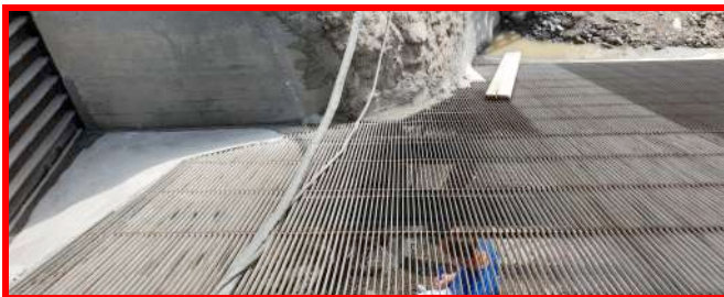
Grilles fines en amont des prises d'eau des turbines (photos SHEM)
