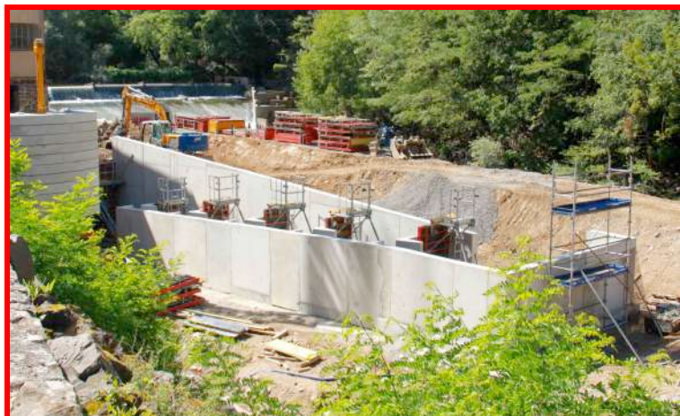
Aval de la passe à poisson
