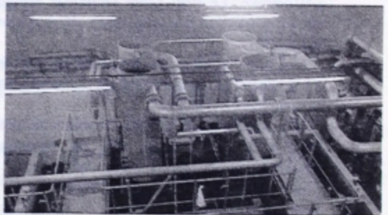
Unité de traitement et de recirculation de l'eau
