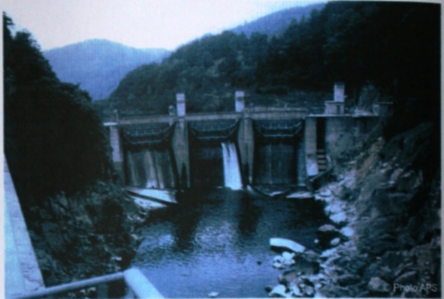
Poutès Monistrol mur de béton qui a réduit l'étendue des frayères de l'Allier, cour d'eau réservé où aucune concession ne doit être accordée...
