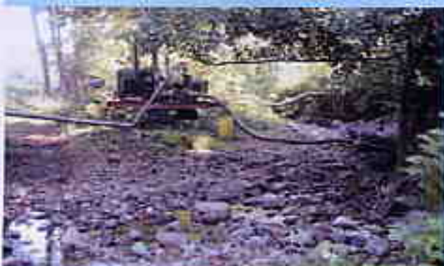
Été 2009, Ruisseau la Peyrusse, commune d'AUBAZAT : station de pompage et ruisseau à sec !!! (Photo APPMA LANGEAC)
