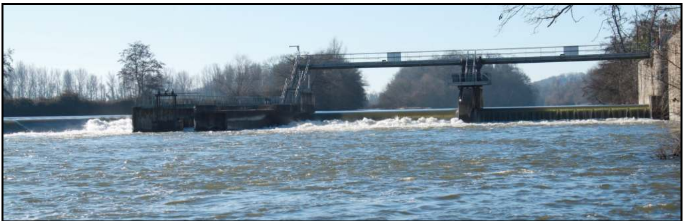
Photo N°3 : à droite le seuil dû à la position des clapets Photos N°1 à N° 3 de l'A.P.S., prises le 9 février 2022
